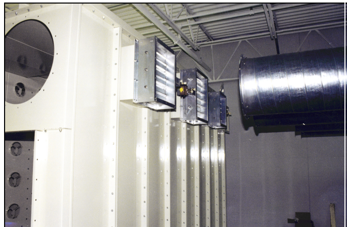
Figura 7 Ductería de un filtro final independiente
